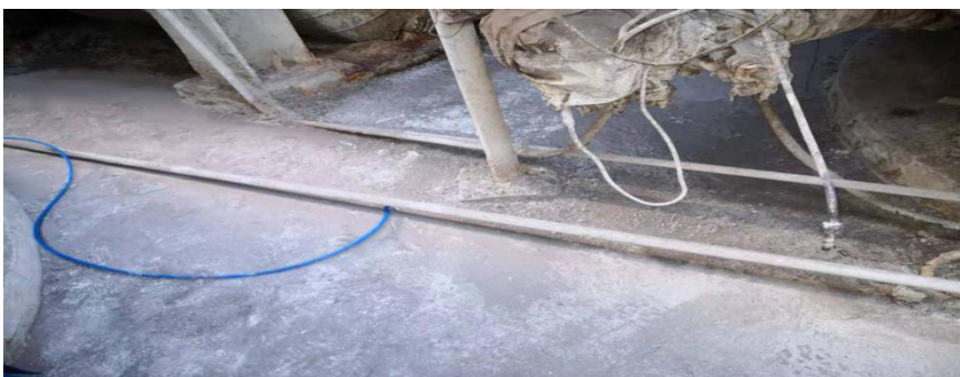
图 4-1 仪表风连接处脱落情况
